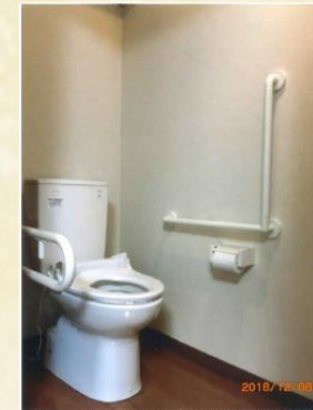
居室内トイレ
